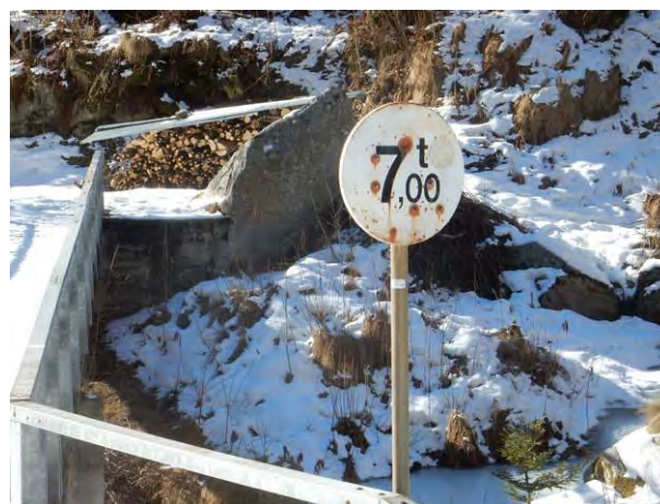
Fotografia 5 - Dettaglio del cartello indicatore della portata massima del ponte esistente, insufficiente alle necessità di una strada forestale.
